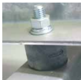
Trillingsdempers De ventilator is gemonteerd op een onderstel met silentblocks om de trillings- en geluidsoverbrenging naar de installatie te beperken.
